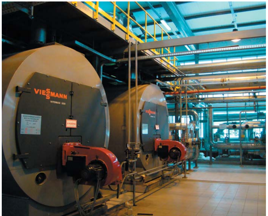
Автоматизированная котельная завода по производству флот-стекла мощностью 40 МВт с котлами Vitomax-200 (Viessmann)
