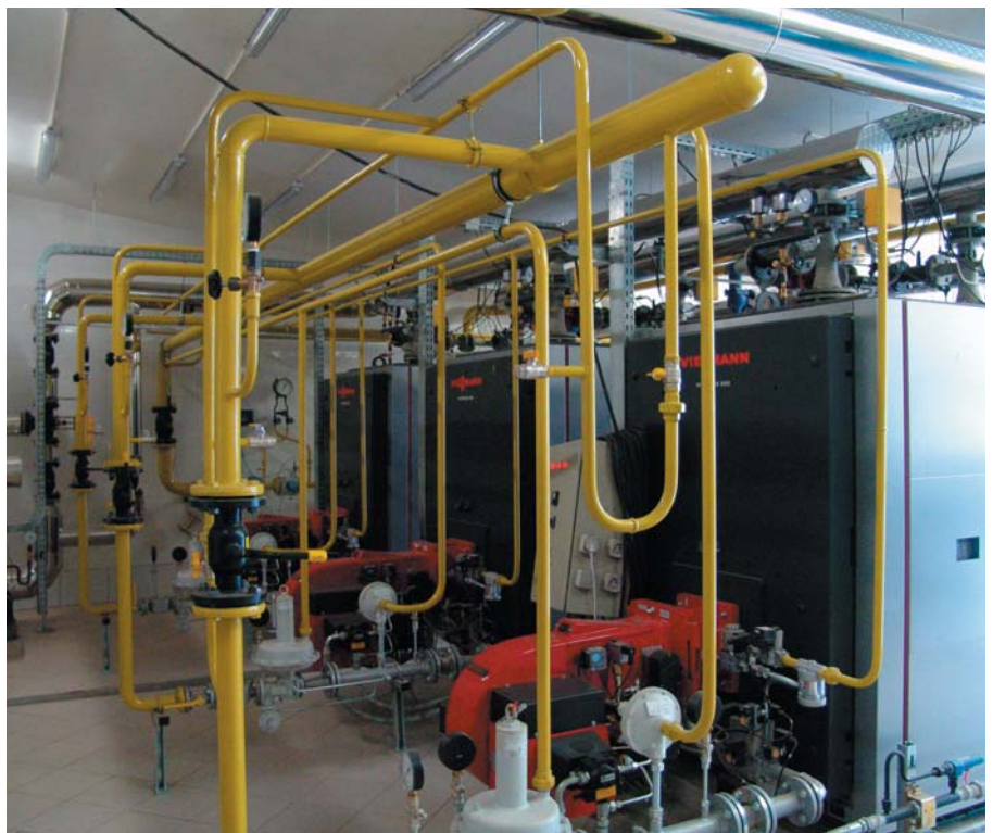
Автоматизированная котельная мощностью 4,5 МВт с котлами Viessmann
